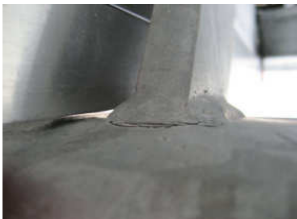
Imaginea 4: Crăpătură – sistem de fixare
