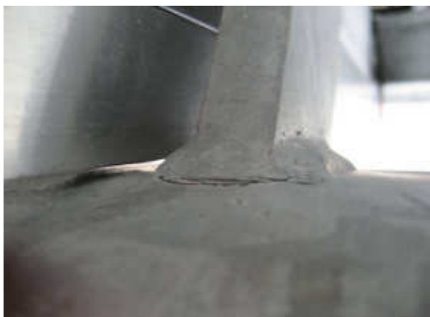
Slika 4. Oštećenje nosača modula
