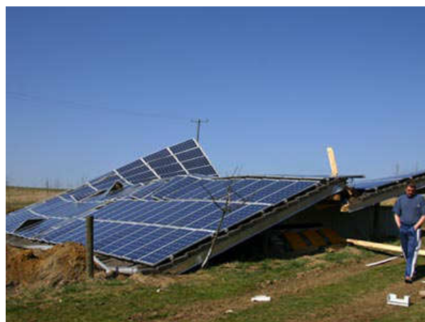
Slika 5. Moduli oštećeni u oluji
