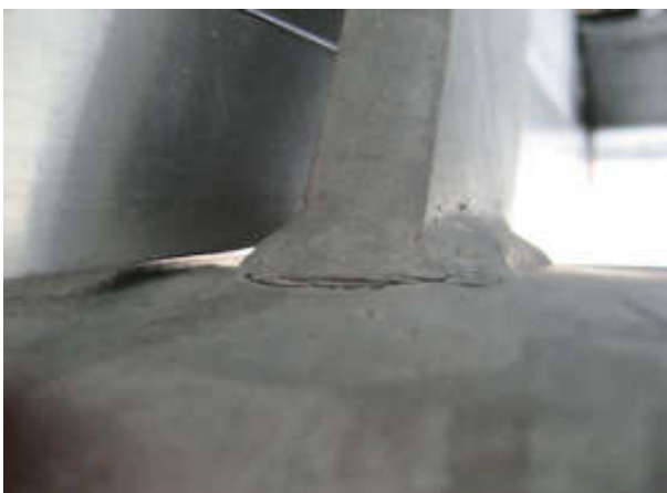
Imagen 4: Daños de rotura en la fijación del sistema
