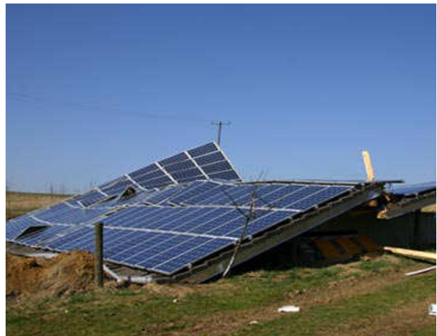
Εικόνα 5: Κατεστραμμένα πλαίσια από
