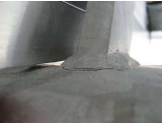
Εικόνα 4: Ρηγμάτωση στη βάση στήριξης καταιγίδα
