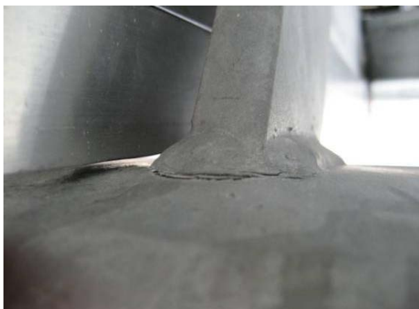
Снимка 4: Повреди от пукнатини на конструкцията
