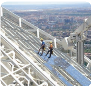
Cristal Tower MARTIFER SOLAR SA
